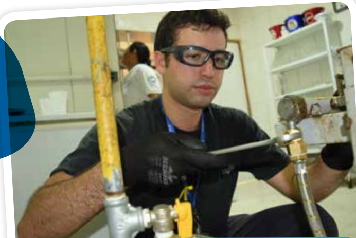
Novos pontos comerciais passaram a receber a interligação junto a rede de gás natural a partir de abril deste ano.
