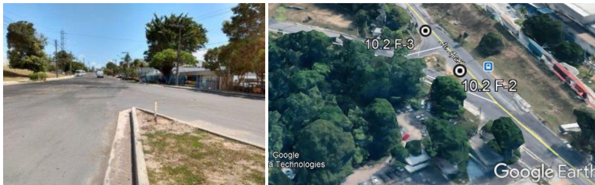
Foto 22 – Falha de Revestimento Av. Açaí - Trevo para Av. Iça
