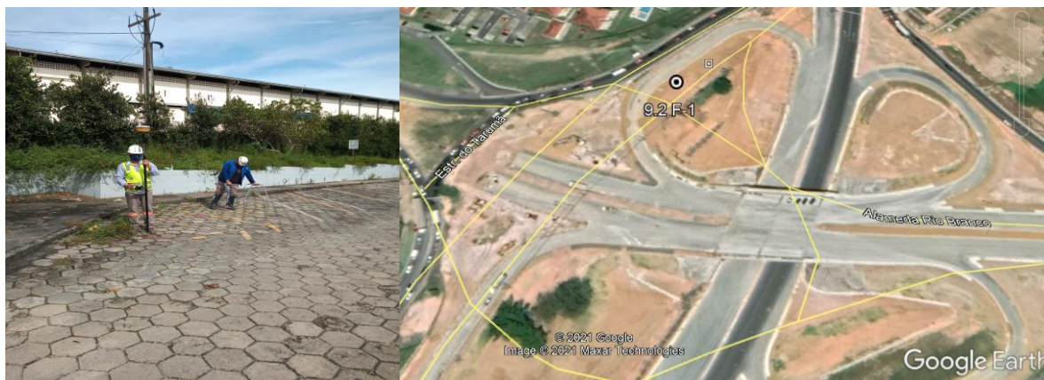
Foto 26 – Falha de Revestimento Ramal Procoating - Derivação do R. Aparecida
