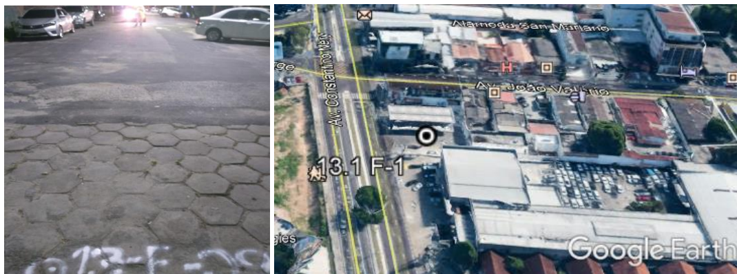
Foto 24 – Falha de Revestimento Área do Posto Constantino Nery
