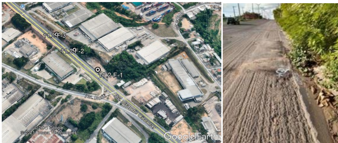
Foto 20 – Falha de Revestimento Av. Autaz Mirim 3
