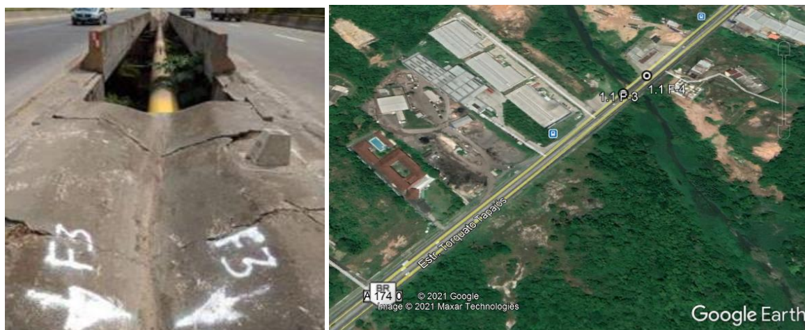
Foto 25 – Falha de Revestimento Início Tubo Camisa Av. Torquato Tapajós
