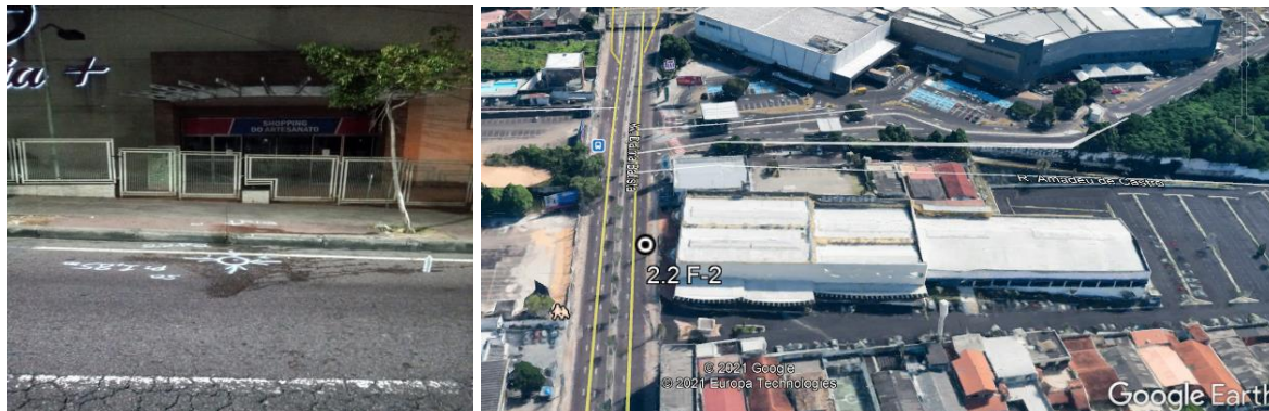
Foto 12 – Falha de Revestimento Próximo Amazonas Shopping
