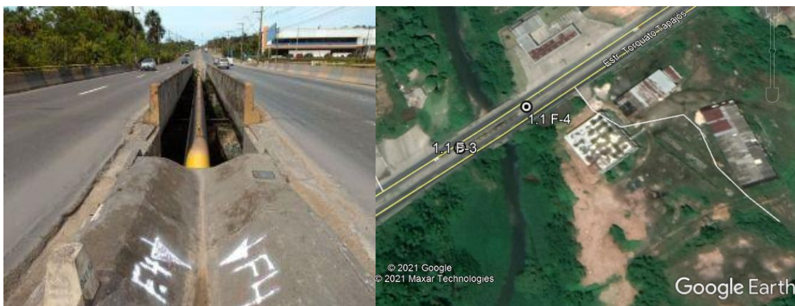
Foto 23 – Falha de Revestimento Saída do Tubo Camisa Av. Torquato Tapajós
