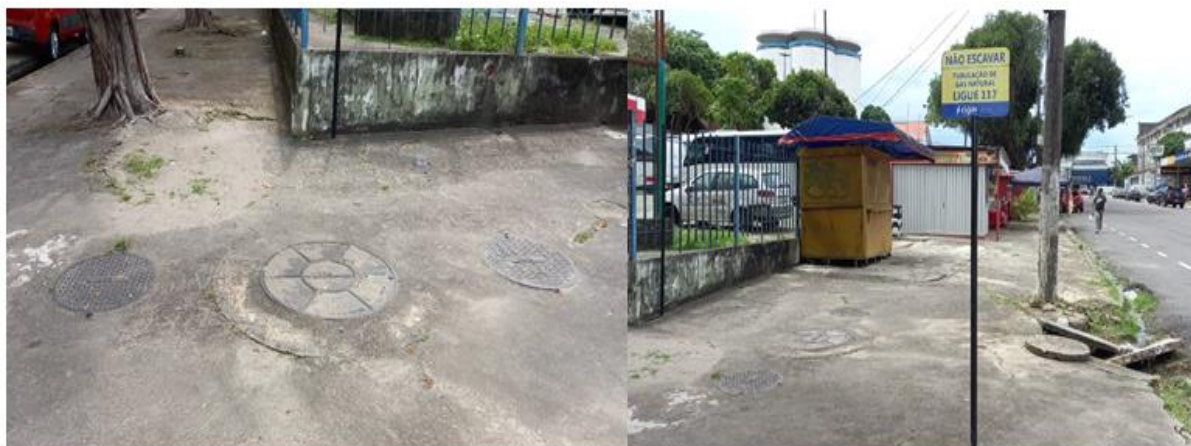
Foto 5 – Caixas de bloqueio R. Ayrão com Ferreira Pena
